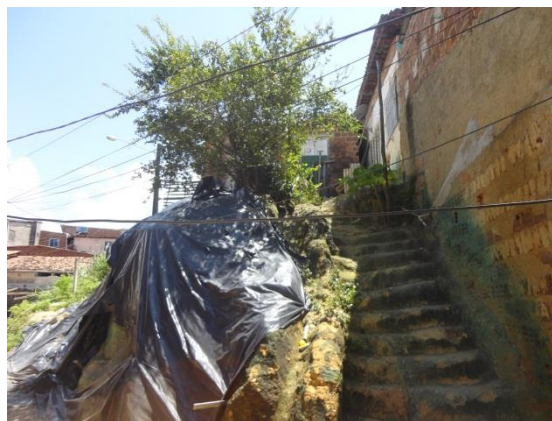
Imagem4: Encosta com risco de deslizamento; acesso precário à habitação.
